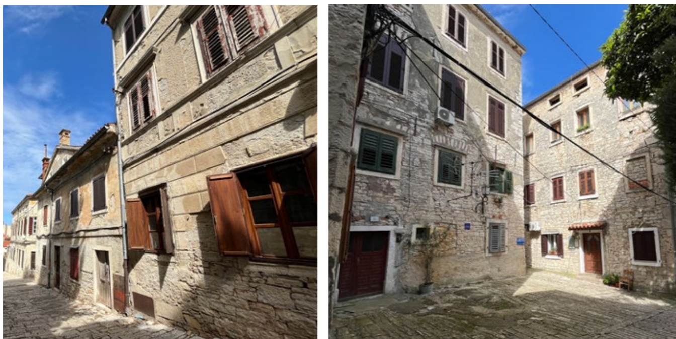
Degradirana vanjšina građevina i upadljiva tehnička oprema u dijelovima povijesne jezgre i usponima prema Kaštelu Izvor: Urbanex d.o.o.
