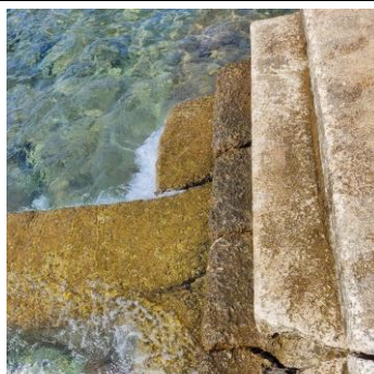
Slika 18: alge na dnu stepeništa
