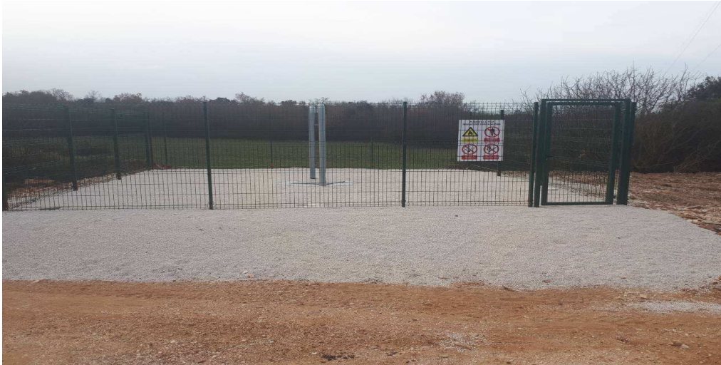
Podzemna regulacijska stanica u industrijskoj zoni Galižana sa pripadajućim ST plinovodom u dužini 1.610m
