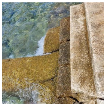
Slika 18: alge na dnu stepeništa
